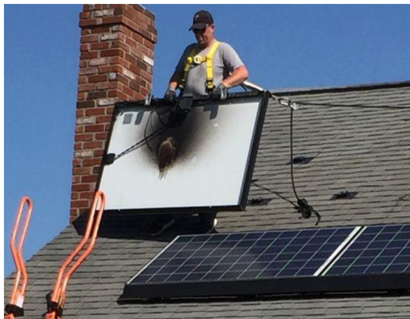
Spalony panel słoneczny usuwany z dachu w USA fot. David Burek/Bloomberg
